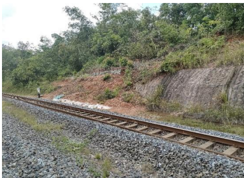
(a) Kondisi longsor pada lereng
