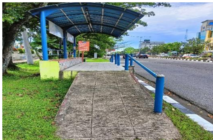
Gambar 4. Kondisi Ramp Halte
