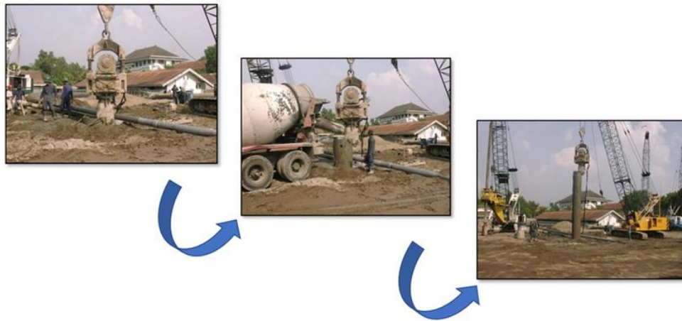
Gambar 12. Tahapan pencabutan pipa tremie dan casing dilakukan setelah proses pengecoran beton selesai.
